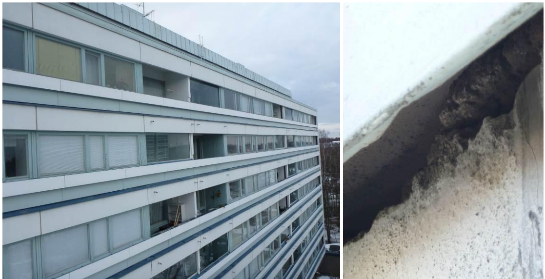
Kuvat 1 ja 2. Julkisivuelementit ovat pääsääntöisesti siistin ja hyväkuntoisen näköisiä. Elementtien yläpuolelta puuttuvat kuitenkin myrskypellit ja pellityksen alla on paikoitellen hieman rapautunutta betonia.
