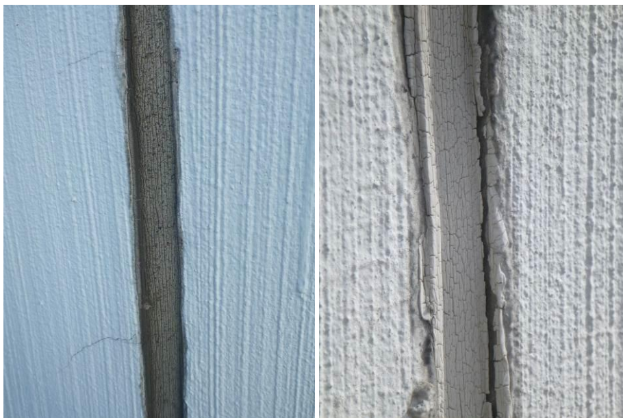
Kuvat 5 ja 6. Julkisivusaumauksen kovettumista ja halkeilua sekä sauman irtoamista alustastaan. Eteläjulkisivujen yläosien saumausten käyttöikä on päättymässä.
