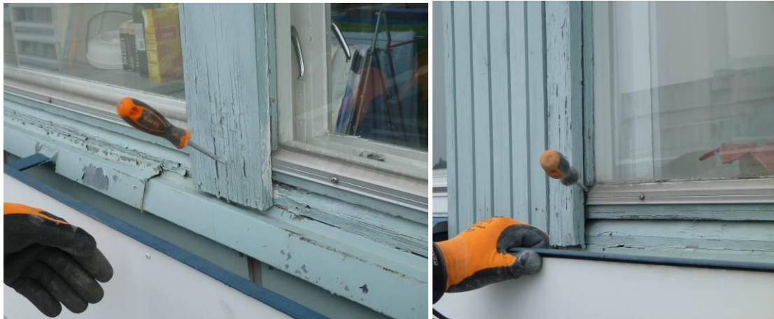
Kuvat 9 ja 10. Julkisivuikkunoiden pinnoite- ja lahovaurioita eteläjulkisivujen ylemmissä osissa. Paikallisia lahovaurioita esiintyy ikkunalistoissa, karmien alakappaleissa sekä ulkopuiteiden nurkissa.
