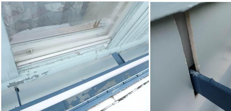
Kuvat 13 ja 14. Julkisivujen levytykset ovat hyväkuntoisia mutta pellitysten maalit hilseilevät. Ulomman levytyksen kannatus saattaa johtaa vettä levytyksen taakse.
