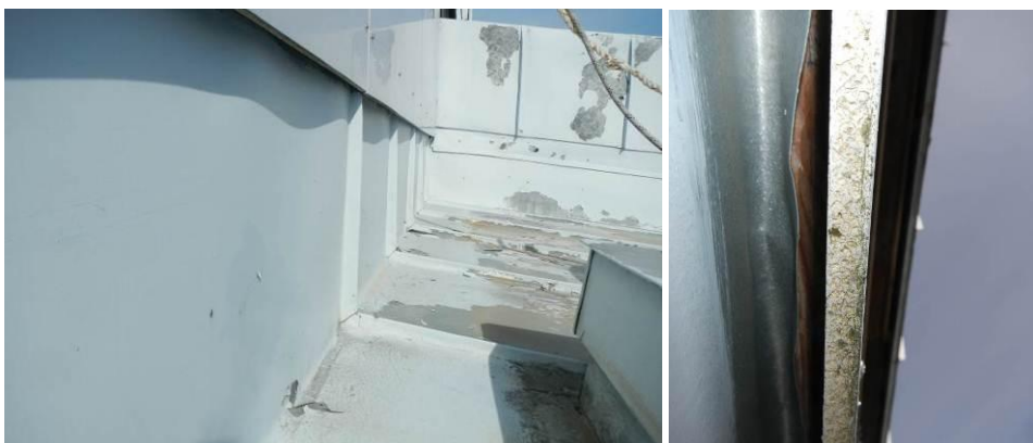
Kuvat 32 ja 33. Alemman katon pellin ylösnoston yläreunan pellitys ei ole tiivis.
