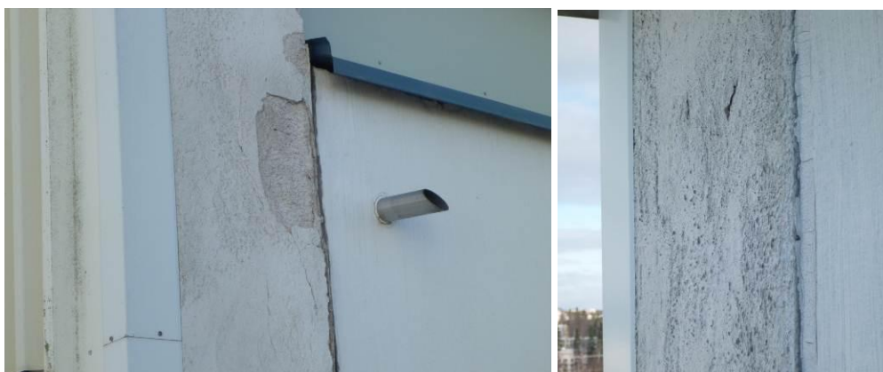
Kuvat 7 ja 8. Päätyseinän otsapinnan rappausvaurioita 4A – talon eteläjulkisivulla.
