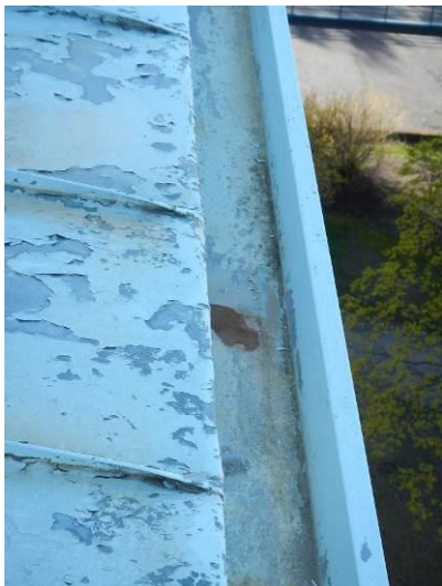
Kuva 34. Räystäskourun maalaus lohkeilee ja pelti on paikoitellen ruostunut.
