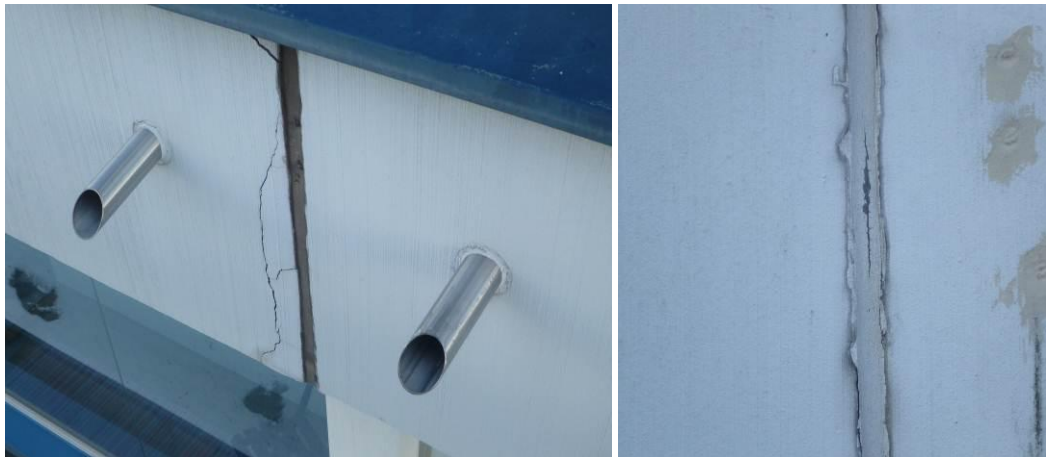
Kuvat 20 ja 21. Parvekekaiteiden ulkopintojen ja saumausten kunto vastaavat julkisivuelementtien kuntoa. Rakenteissa esiintyy paikallisia vaurioita ja saumausten käyttöikä on päättymässä.
