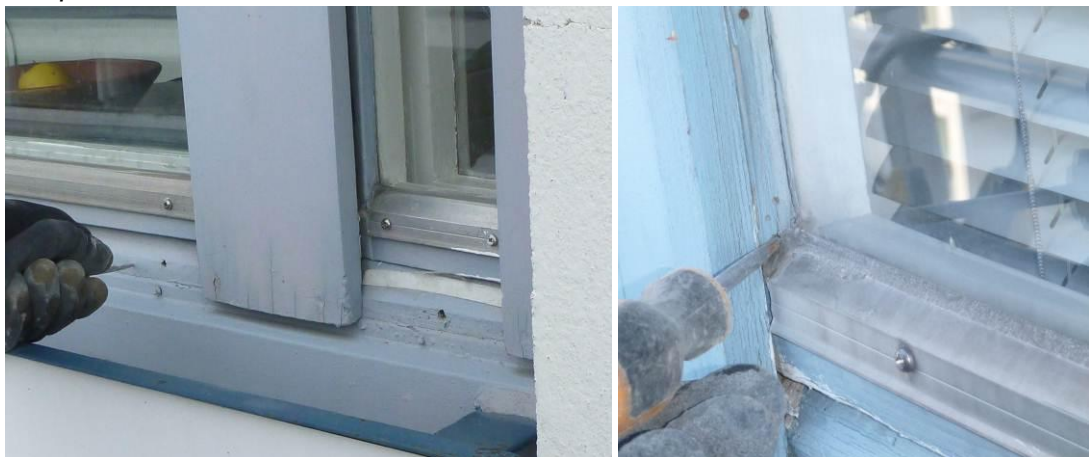
Kuvat 11 ja 12. Pohjoisjulkisivujen ikkunarakenteet ovat selvästi parempikuntoisia eikä merkittäviä lahovaurioita havaittu, joskin paikoitellen esiintyi puun halkeilua ja alkavaa pinnan pehmenemistä.
