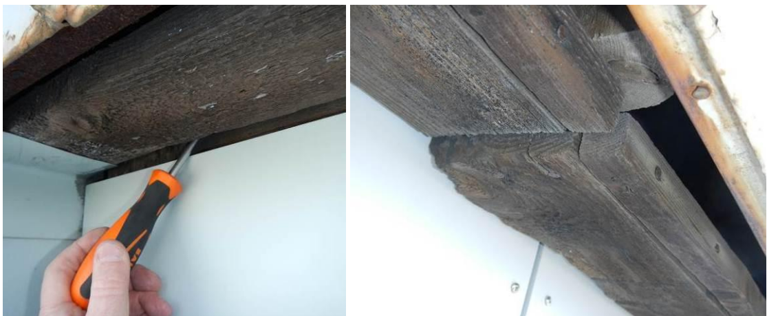
Kuvat 30 ja 31. Ylempien räystäiden ja seinäpeltien välissä on rakoja. Laudoitus on pääosin huonossa kunnossa ja lautojen kiinnitys on paikoin irtoamassa.
