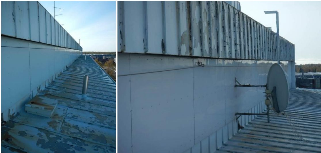
Kuvat 28 ja 29. Maali on lohkeillut pois lähes kokonaan kaikilta alemmilta katoilta. Pelti on paikoitellen ruostunut. Räystään pellityksen maalaus lohkeilee ja pelleissä on ruostetta. Katolla on antenni, jotka on poistettu käytöstä.
