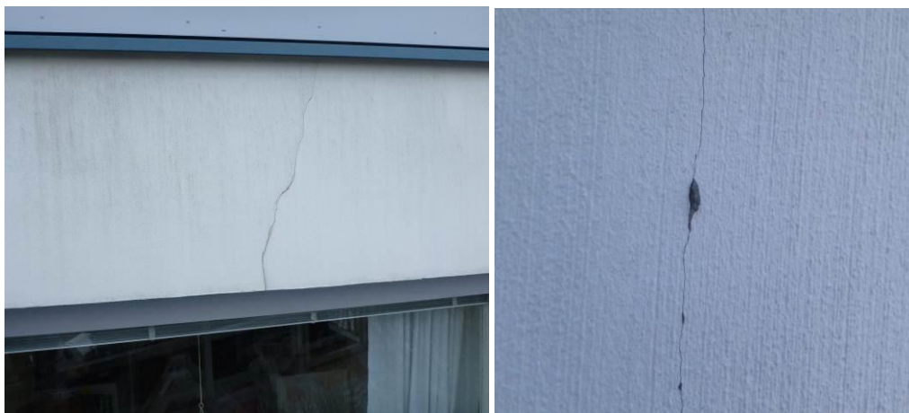
Kuvat 3 ja 4. Yksittäisissä julkisivuelementeissä esiintyy paikallisia pystysuuntaisia halkeamia tai säröjä. Myös yksittäisiä elementin reunan lohkeamia havaittiin.
